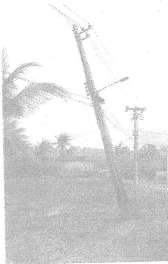
Rua Pérola, próximo ao nº 26, Mazomba.
